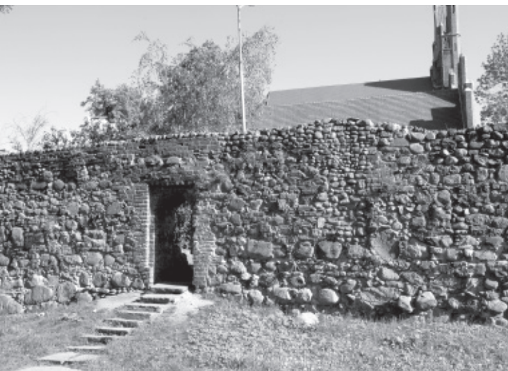
Il. 18. Prześciec wybite w odcinku muru obronnego, biegnącego za parkingiem od ul. Bramkowej wzdłuż ul. Szpitalnej. Widok z terenu dawnej fosy w stronę kościoła pw. Michała Archanioła. Stan z 24 maja 2015, fot. Tomasz Kalicki
