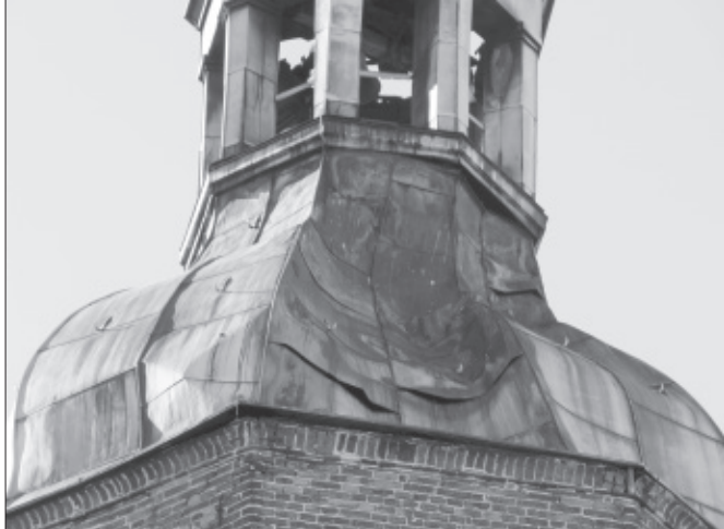
Il. 3. Zdeformowany hełm wieży po pożarze, fot. Henryk Kustosz
