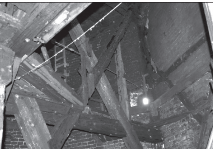
Il. 2. Partia zniszczonej pożarem konstrukcji wieży, fot. Dariusz Górny
