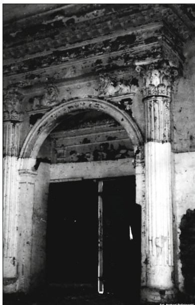
Il. 12. Wnętrze synagogi przed remontem, widok na Aron ha-Kodesz , 2001, fot. A. Paśniewski
